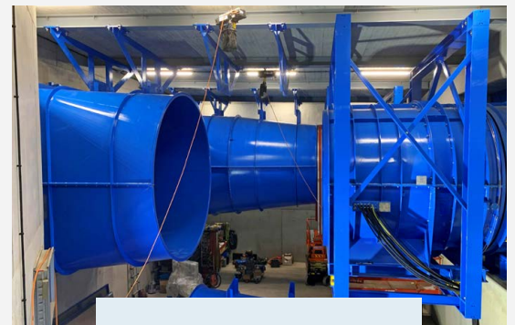
Umweltlüfter im Lüftungsbauwerk Tierspital
